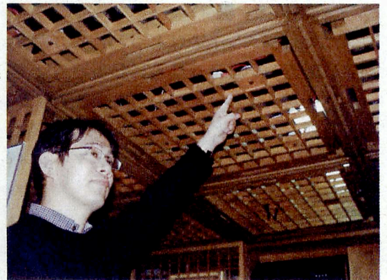
天井に設置されたセンサー
