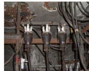
電気ケーブルの劣化
