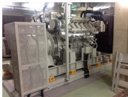
図 4 常用発電装置の外観
