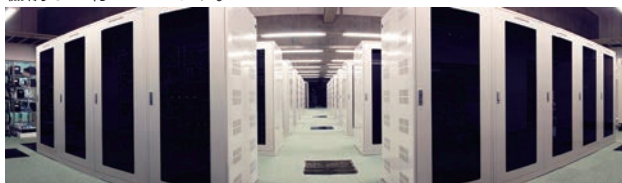
StarBED 大規模ネットワークエミュレーション施設
